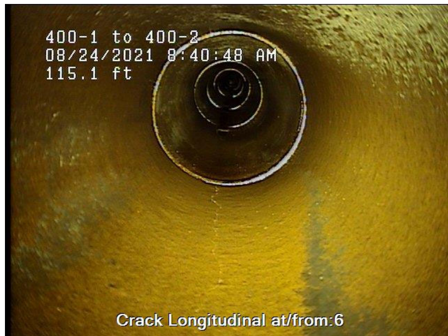
Example: Longitudinal Crack
